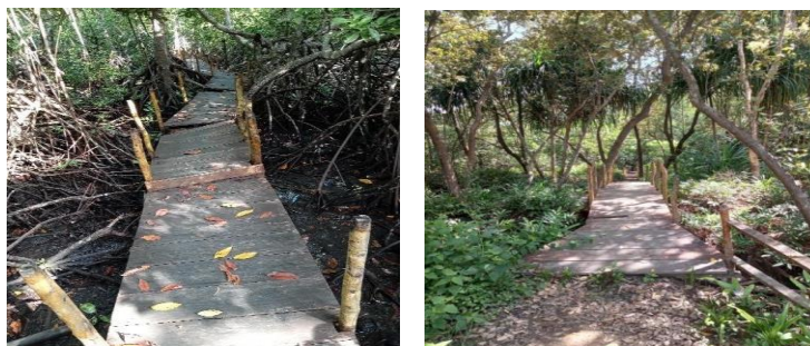
Gambar 2 Kondisi jalan wisata mangrove
